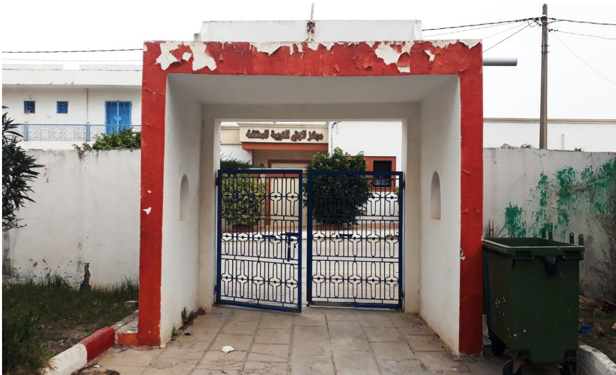
PORCHE NON ENTRETENUE
