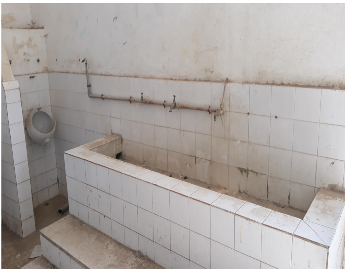
ÉTAT DÉGRADÉ DES ANCIENNES TOILETTES
