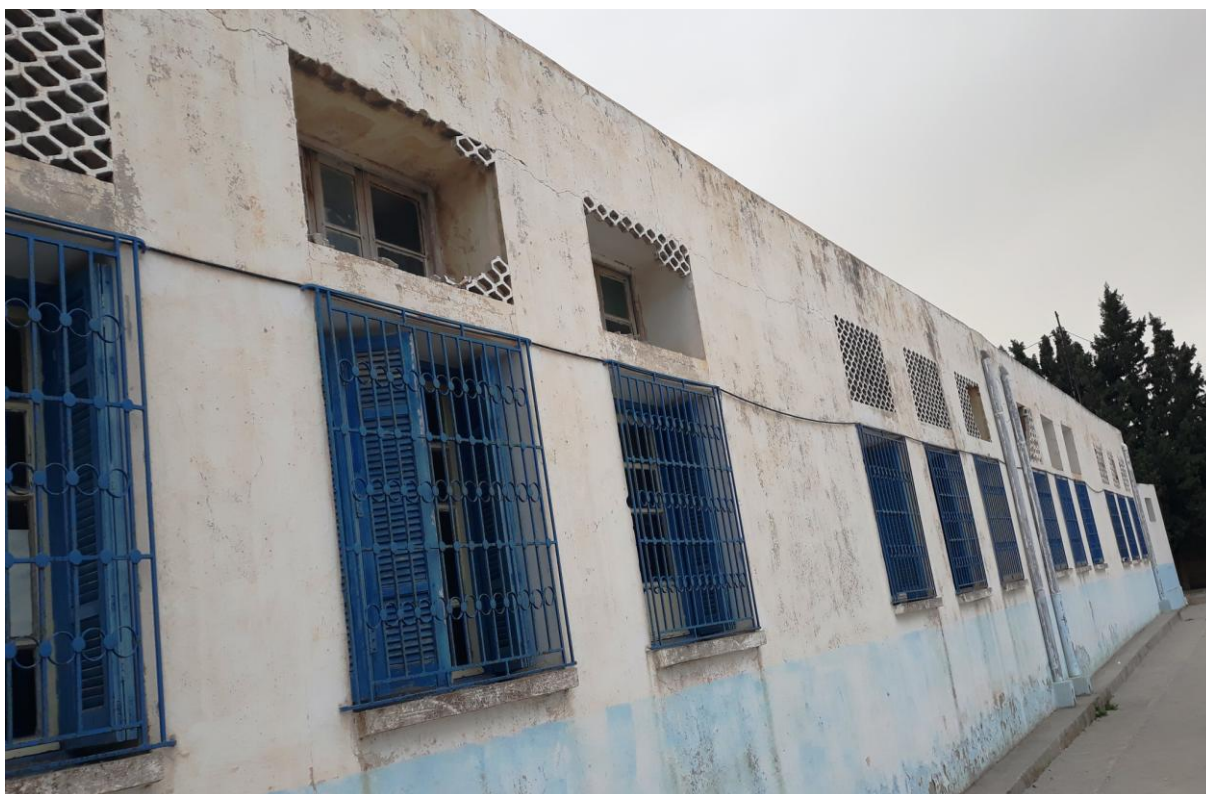
FENETRES POSTÉRIEURES A REPRENDRE
