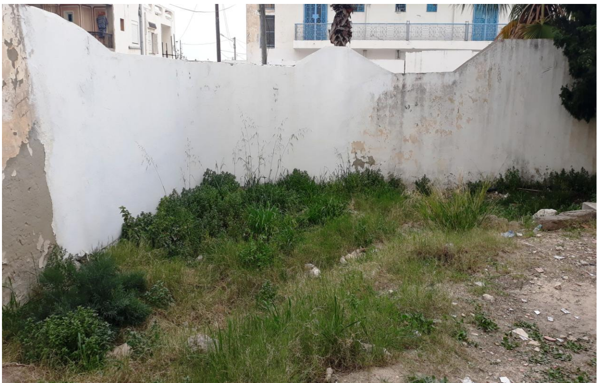
MUR ALTERE PAR L'HUMIDITE
