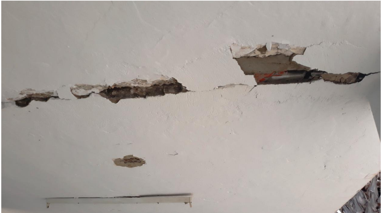
CHUTE DE BÉTON NUISIBLE
