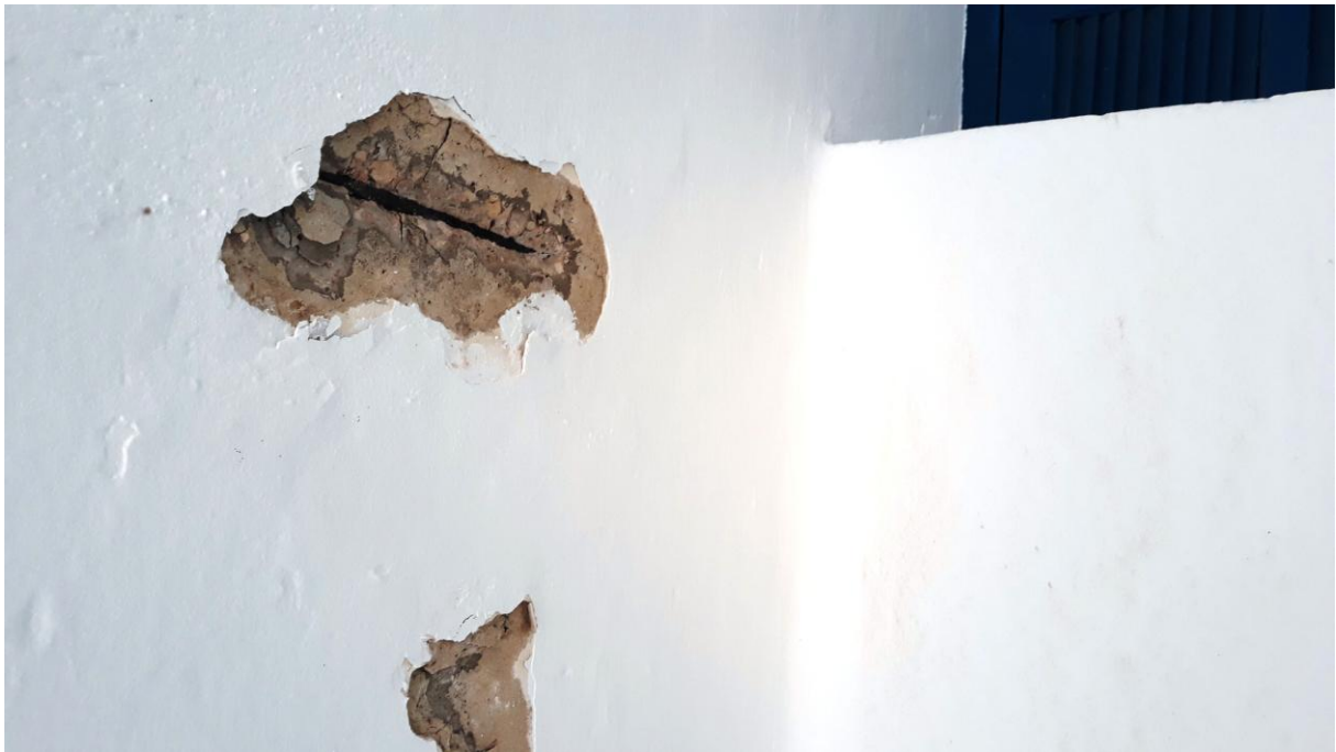
CHUTE DE BÉTON NUISIBLE
