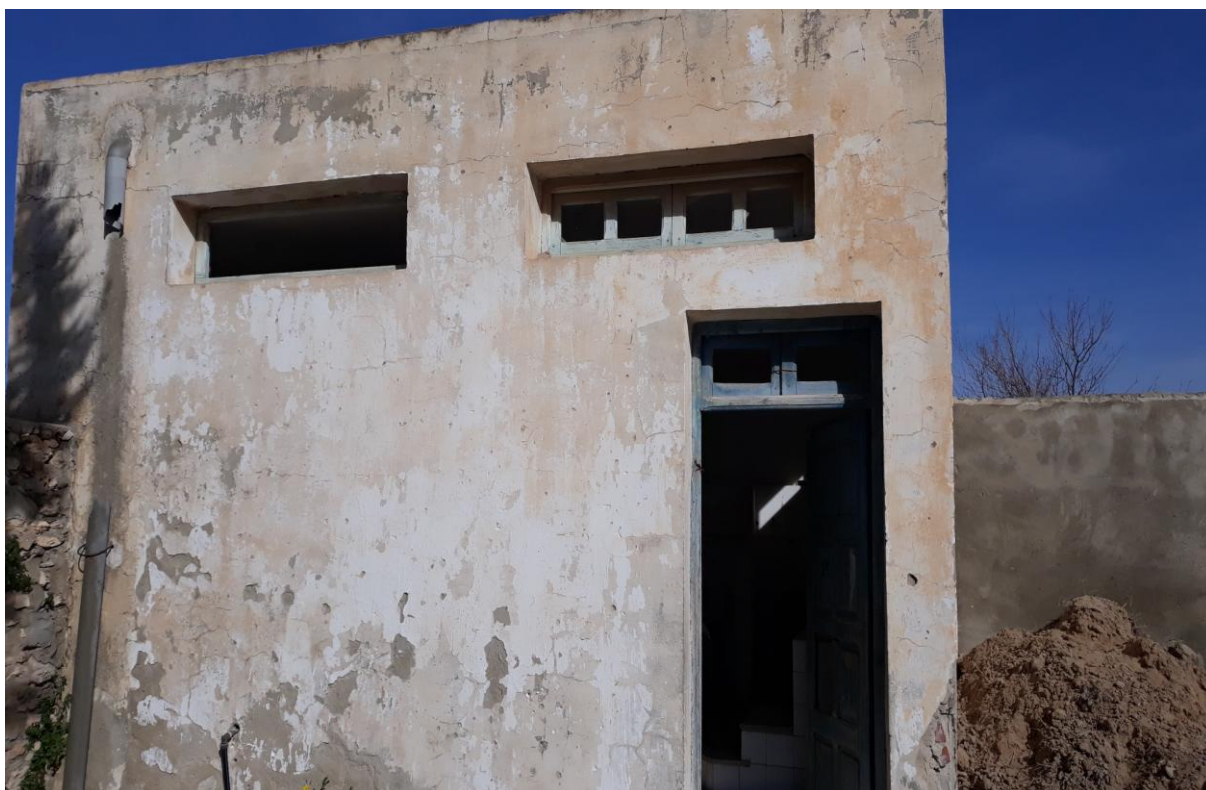
ÉTAT DÉGRADÉ DES ANCIENNES TOILETTES
