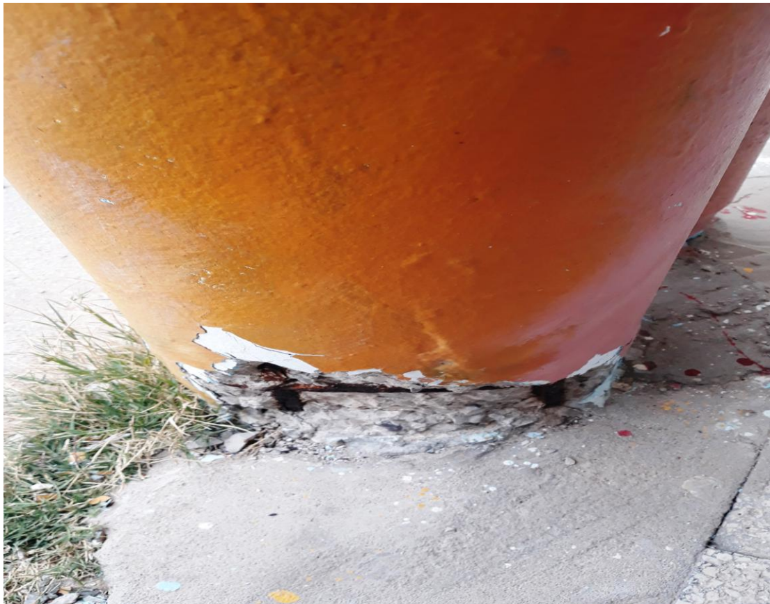
POTEAU AVEC BÉTON DÉGRADÉ
