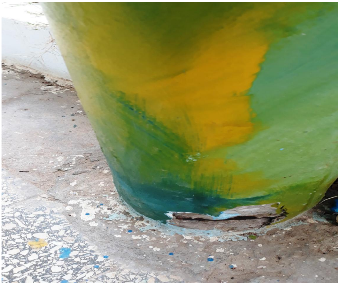
POTEAU AVEC BÉTON DÉGRADÉ
