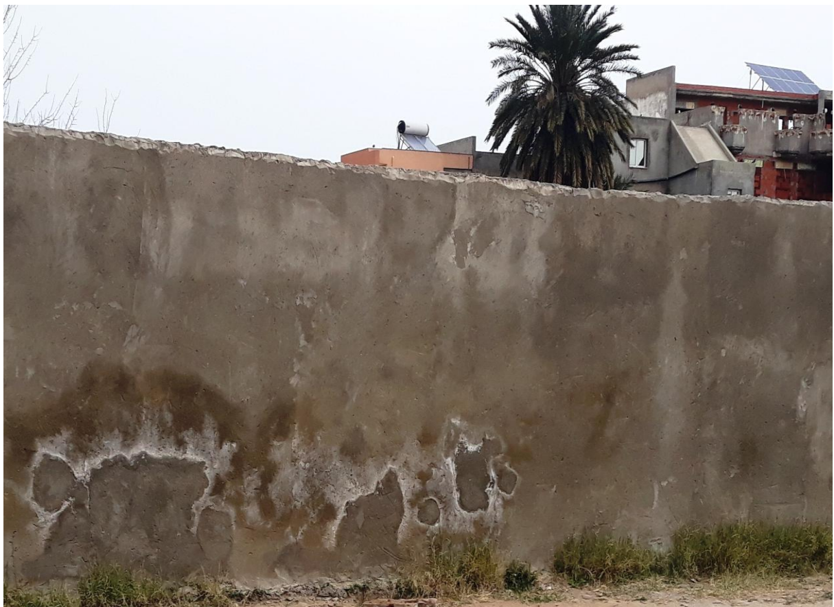
MUR ALTÉRÉE PAR L'HUMIDITÉ
