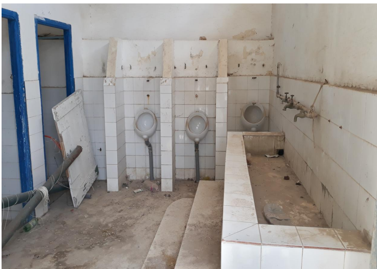
ÉTAT DÉGRADÉ DES ANCIENNES TOILETTES
