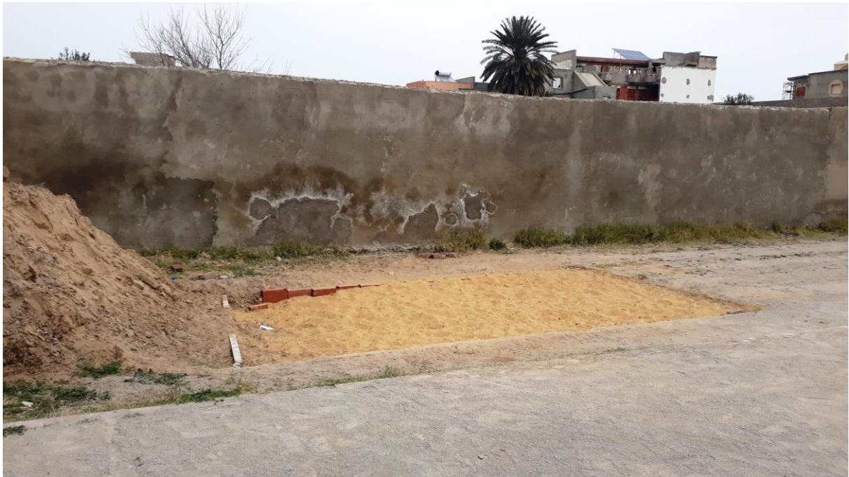
MUR ALTÉRÉE PAR L'HUMIDITÉ
