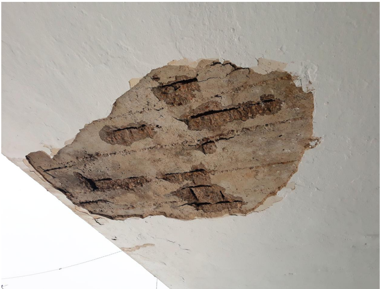
CHUTE DE BÉTON NUISIBLE
