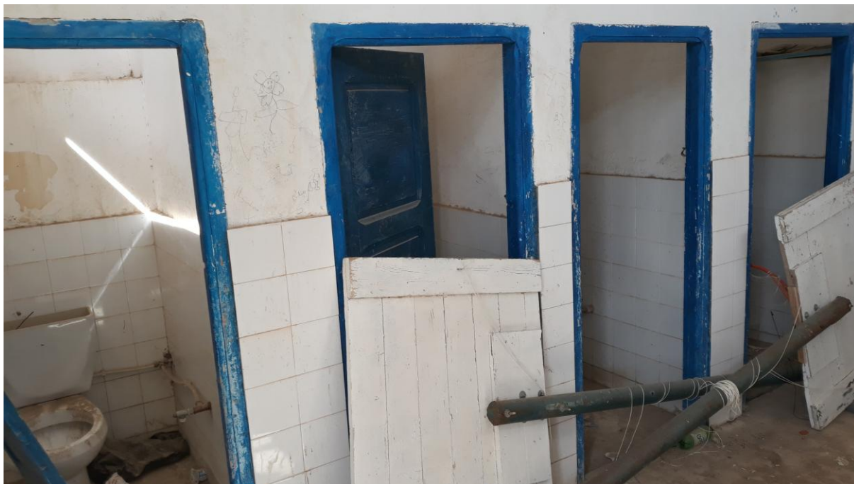
ÉTAT DÉGRADÉ DES ANCIENNES TOILETTES
