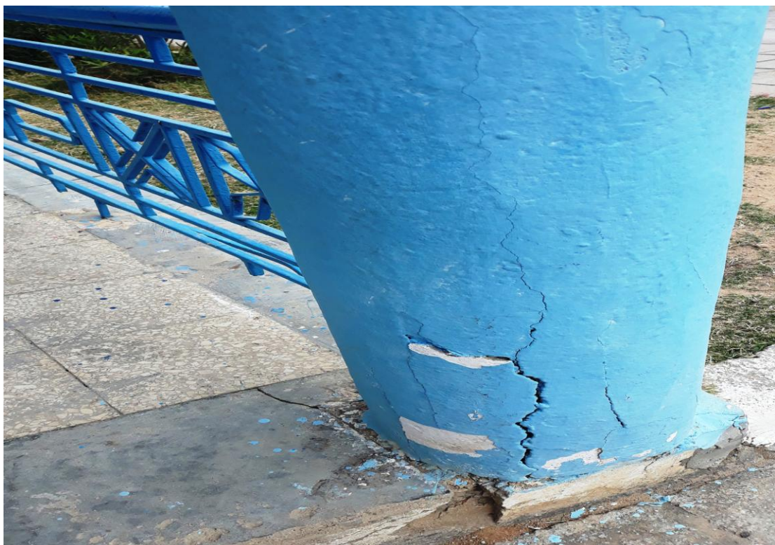
POTEAU AVEC BÉTON EXPLOSE
