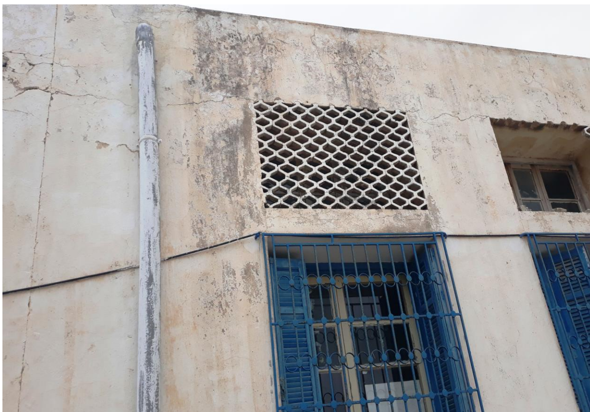
FENETRES POSTÉRIEURES A REPRENDRE
